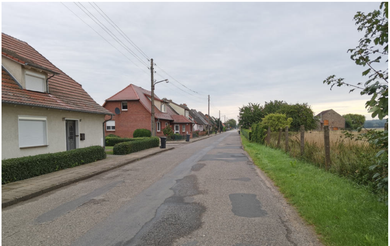
Foto 8: Blick Richtung Ortsausgang: Die Fahrbahn ist auch hier durch Flickungen und Risse gekennzeichnet
