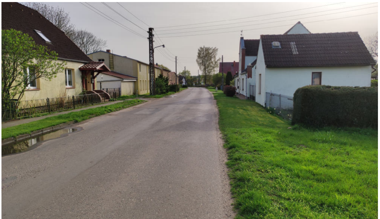
Foto 6: In Bereichen ohne Bordstein sind die Bankett allgemein ungepflegt und zu hoch
