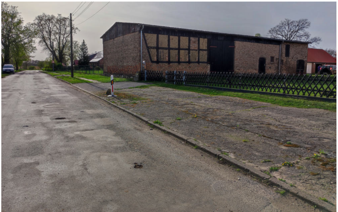
Foto 2: Die Kreisstraße ist durch Unebenheit, Risse und Flickungen sowie Schlaglöcher gekennzeichnet
