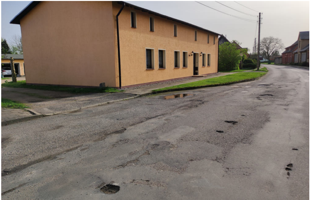
Foto 5: Die Dorfstraße ist in Teilbereichen durch Risse und Ausbrüche im Asphalt stark geschädigt
